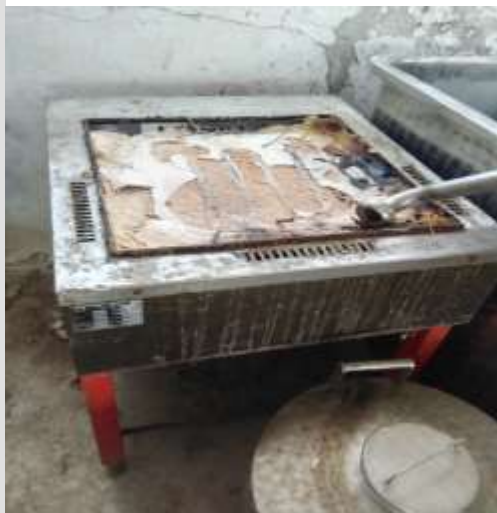
14. Skara elektrike- gjendje.pune pa verifikuar
